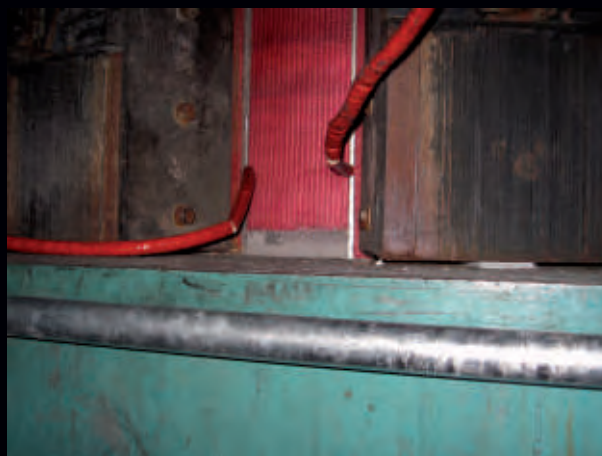
Elektrischer Anschluss der SAVESEARCH ® -Elektroden in einem 10 t Ofen
