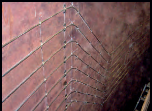
OPTISAVE-Installation an der Innenseite eines wassergekühlten Niederschichtlichtbogenofens
